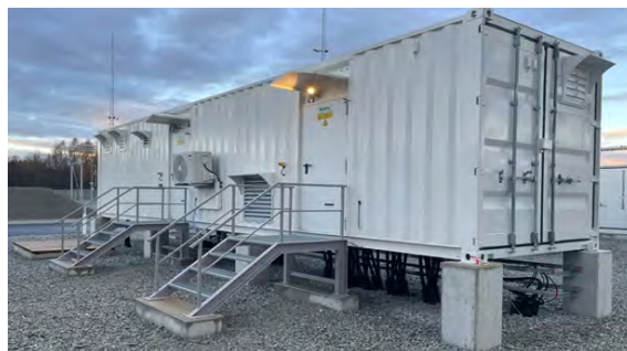
Container batterie sur longrines avec accès escalier métallique – référence AMBI Energy
