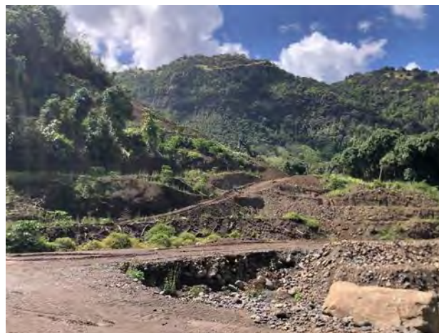
Parcelle A3406 – zone d'évacuation des déblais pour remise en état du site
